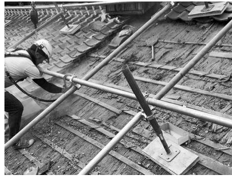
写真 5.4.16 改修前 杉皮の状況
