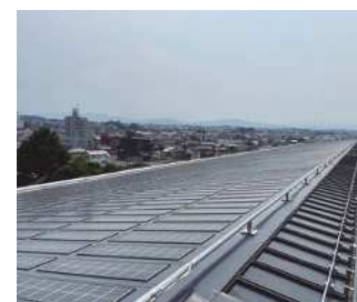
深谷市役所本庁舎の太陽光発電設備
