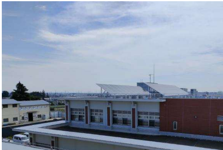
岡部浄水場内 太陽光発電設備
