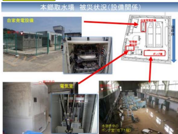
写真 3-4 取水場への浸水被害状況(設備) (広島県三原市本郷町：本郷取水場)
