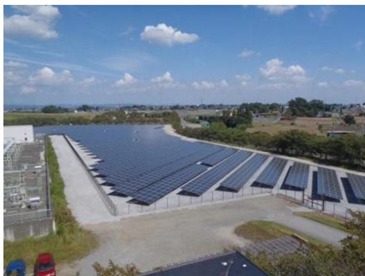
深谷市浄化センター太陽光発電所（メガソーラー）
