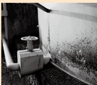
▲ろ過機の腐食の様子
