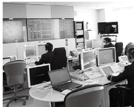
▲現在使用している『消防通信指令台』
