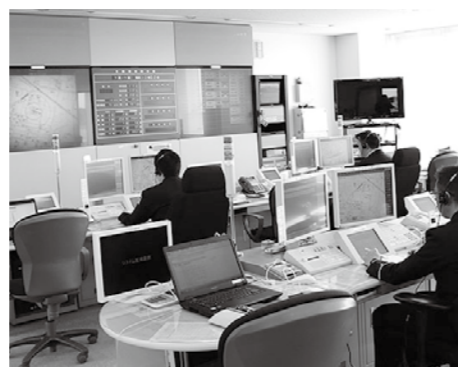
▲現在使用している『消防通信指令台』
