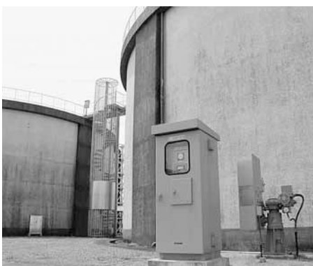
▲⑥血沼浄水場の配水池に設置された緊急遮断弁(写真右下)
