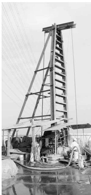
▲⑥岡部浄水場のさく井工事：井戸の掘削工事では深さが約200mに達します
