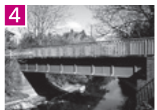
4 備前渠鉄橋 (国重要文化財) 旧日本煉瓦製造(株)近くの遊歩道終点にあるポータル型プレートガーダー橋です。専用線に架けられた鉄橋は、当時4本ありましたが、この橋はその中で最長の15.7mあります。橋の手前には、長さ約2mの煉瓦アーチ橋(写真下)が架かっています。
