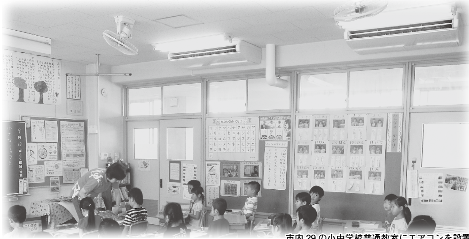
市内 29 の小中学校普通教室にエアコンを設置
