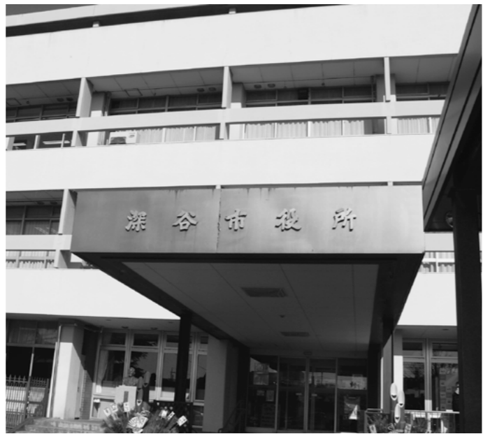
築48年の庁舎。老朽化が進んでいる
