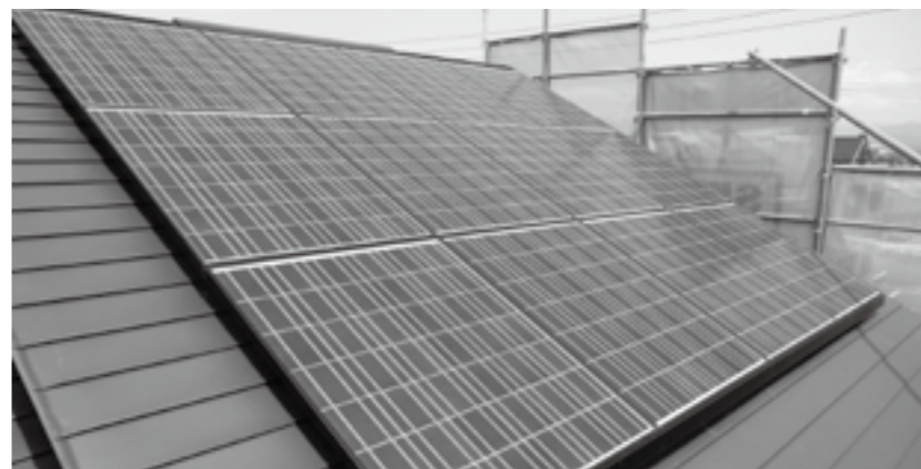
太陽光パネル
