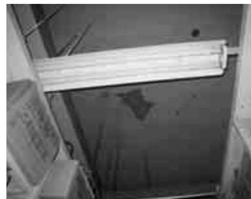
東日本大震災で被害のあった庁舎地下の天井
