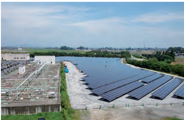
浄化センターのメガソーラー
