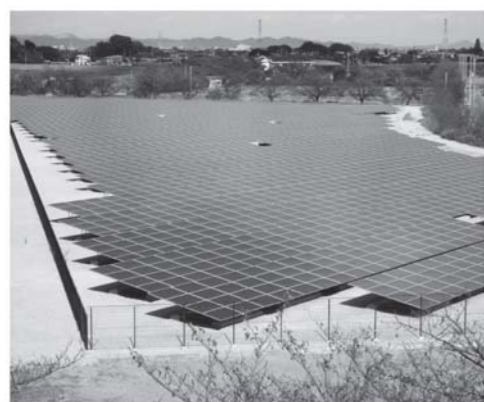
市浄化センターのメガソーラー
