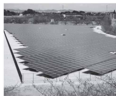
市浄化センターのメガソーラー
