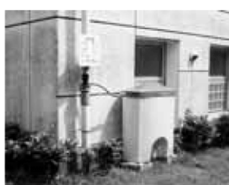
雨水貯留タンク
