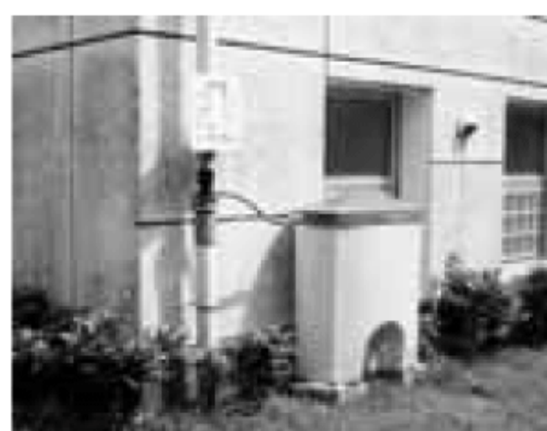
雨水貯留タンク
