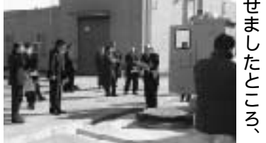
皿沼浄水場配水池緊急遮断弁
