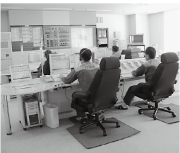
消防本部通信指令室
