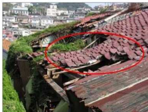
柱、はりの破損や変形が著しく崩壊の危険がある例 (評点100点)
