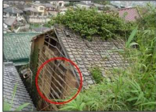
外壁が剥落し、著しく下地が露 出するとともに、壁体を貫通する 穴を生じている例（評点25点）
