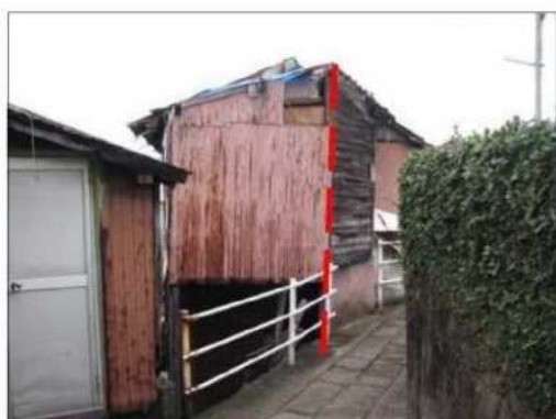
一部の柱が傾斜している例 (評点25点)
