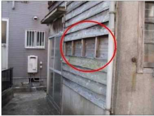
外壁の仕上材の一部がはがれ、 下地が露出している例（評点15点）
