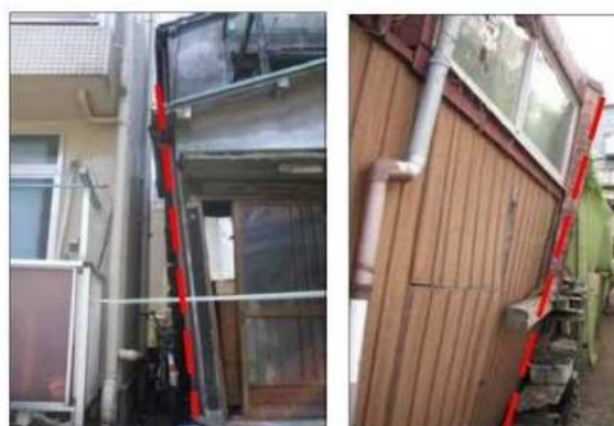
柱の変形が著しく崩壊の危険がある例 (評点100点)
