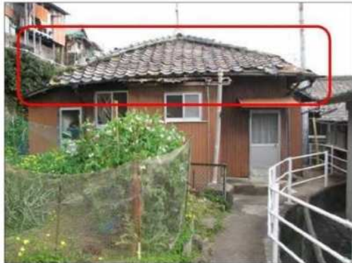
屋根に不陸がある例（評点50点）
