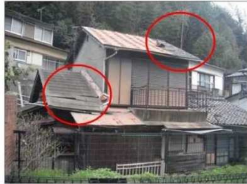
アスファルト屋根等の一部に ズレがあり、雨漏りのある例（評点15点）
