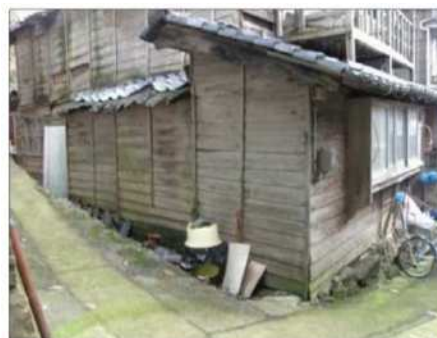
外壁が裸木造の例
