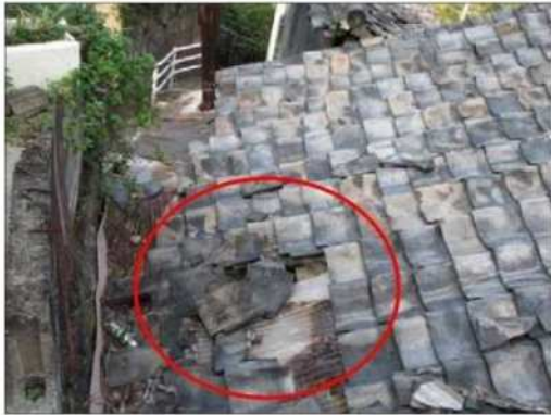
瓦の一部に剥離とズレがあり、 雨漏りのある例（評点15点）
