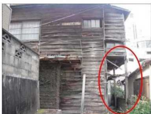
柱の数箇所に破損がある例 (評点50点)
