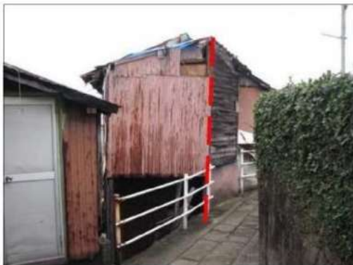
一部の柱が傾斜している例 (評点25点)
