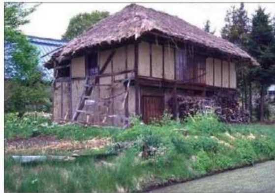
屋根材がワラの例 (評点10点)
