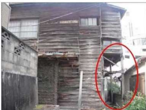
柱の数箇所に破損がある例 (評点50点)
