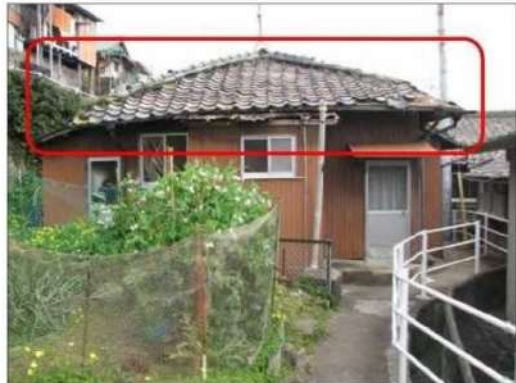
屋根に不陸がある例（評点50点）
