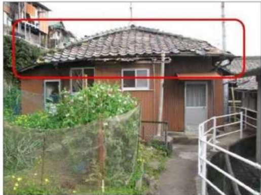
屋根に不陸がある例（評点50点）
