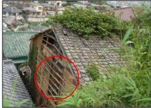
外壁が剥落し、著しく下地が露 出するとともに、壁体を貫通する 穴を生じている例（評点25点）
