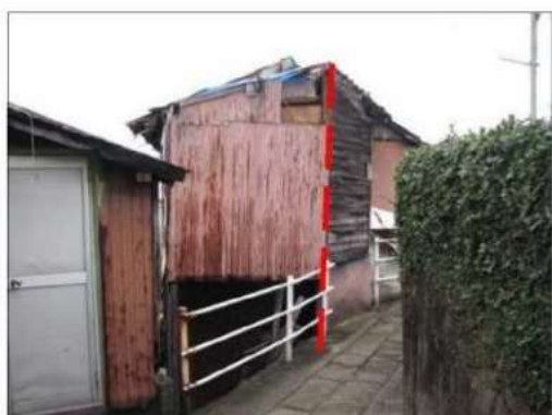
一部の柱が傾斜している例 (評点25点)
