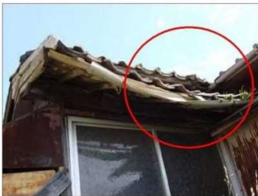
軒の裏板、たる木等が腐朽し、 軒が垂れ下がっている例（評点25点）
