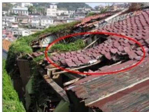
柱、はりの破損や変形が著しく崩壊の危険がある例 (評点100点)
