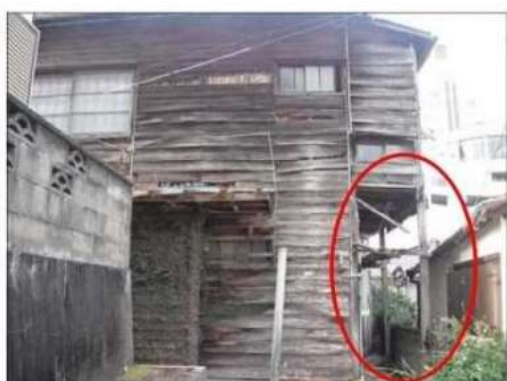
柱の数箇所に破損がある例 (評点50点)
