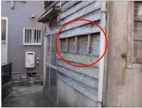
外壁の仕上材の一部がはがれ、 下地が露出している例（評点15点）
