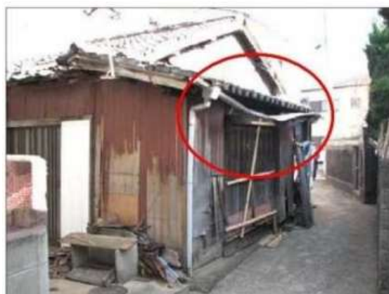
雨樋が壊れており、機能的には 雨樋はないと同様の例 (評点10点)
