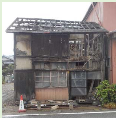
老朽化して危険性のある空き家の例
