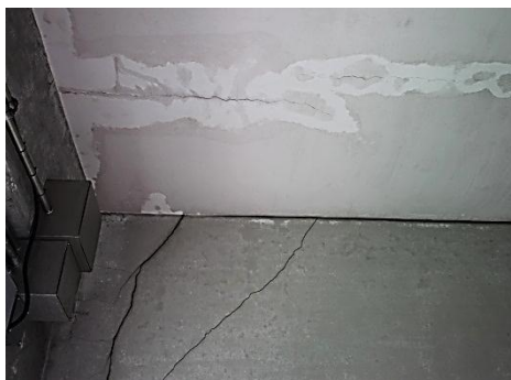
天井と壁面の亀裂
