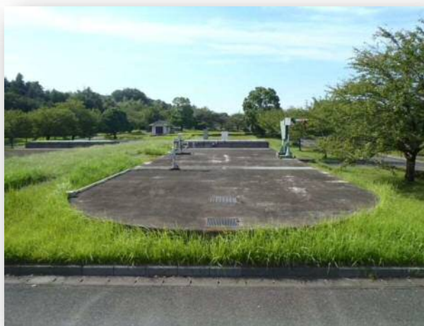
○オキシレーションディッチ
