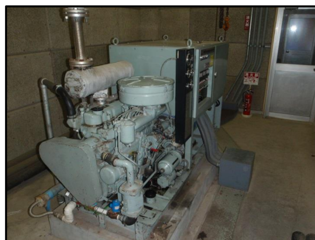
第2配水場 自家発電設備
