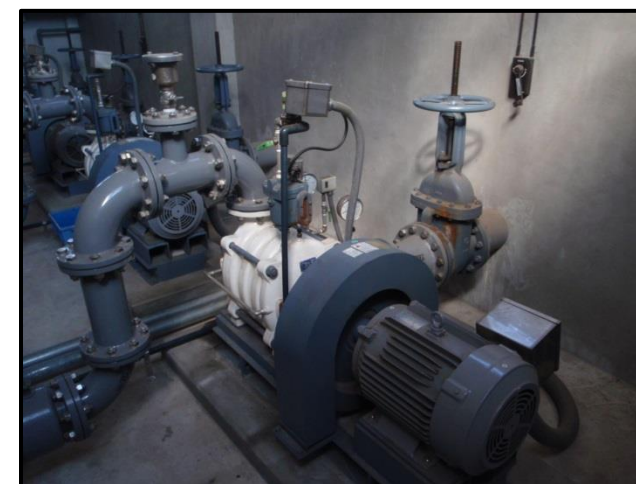
第1配水場 送水ポンプ
