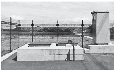
① 深井戸からポンプで地下水をくみ上げます。
