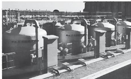
④ 地下水に含まれる鉄とマンガンを取り除きます。
