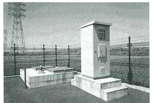
地下水をくみ上げ浄水場へ送る取水設備（岡部浄水場系水源）
