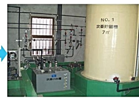
④消毒施設 消毒剤(次亜塩素酸ナトリウム)で消毒・滅菌するための設備。
