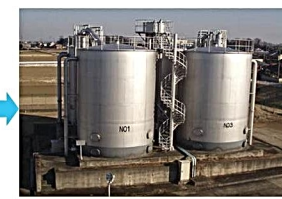
⑤除鉄・除マンガン装置 地下水に含まれる、鉄とマンガンを取り除く装置
