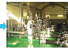
⑦配水ポンプ ポンプで市内の家庭や学校に水を送る。
