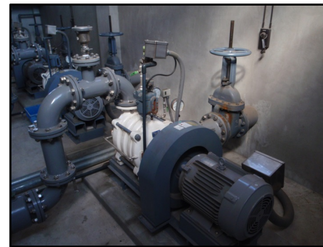
第1配水場 送水ポンプ
