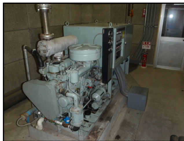
第2配水場 自家発電設備
