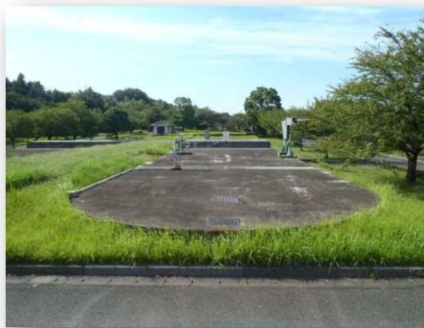
○オキシレーションディッチ
