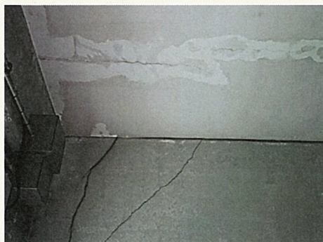
天井と壁面の亀裂
