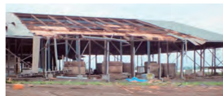
突風被害を受けた工場
