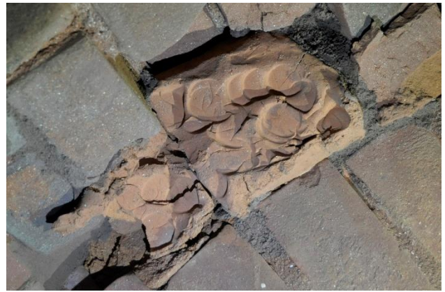
煉瓦窯稼働当時の補修痕
